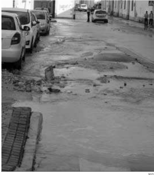
La rotura de la tubería se produjo en la tarde de ayer.
